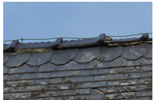
Uitgevallen mortel nokpannen
